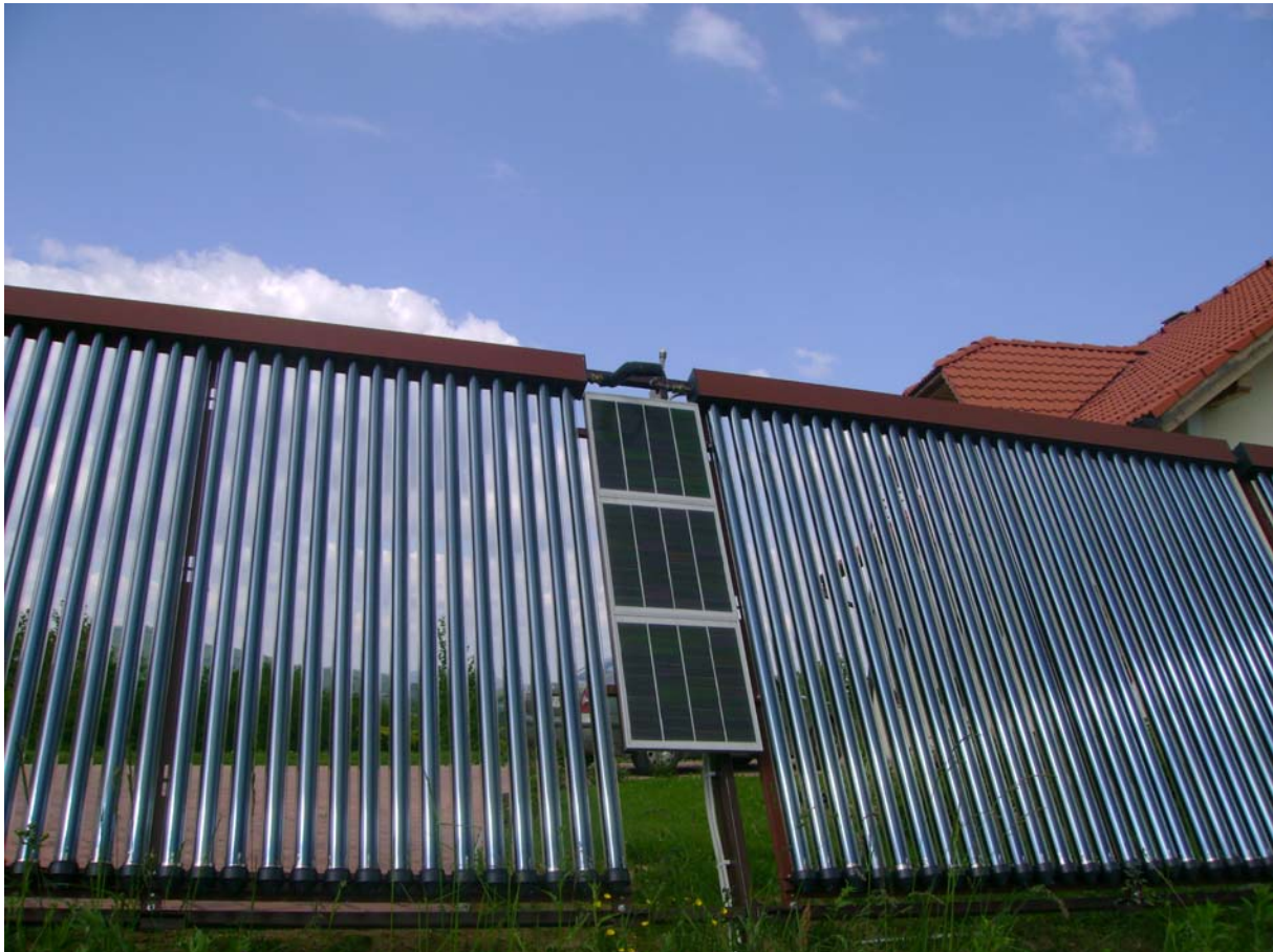
Slika 4: Niz vakuumskih cevi, na sredini so sončne celice
