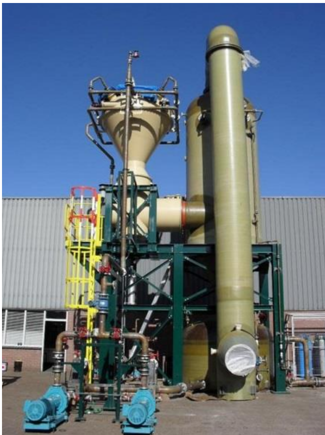
Venturi scrubbers se uporabljajo predvsem za odstranjevanje drobnih delcev iz plinskega toka.
